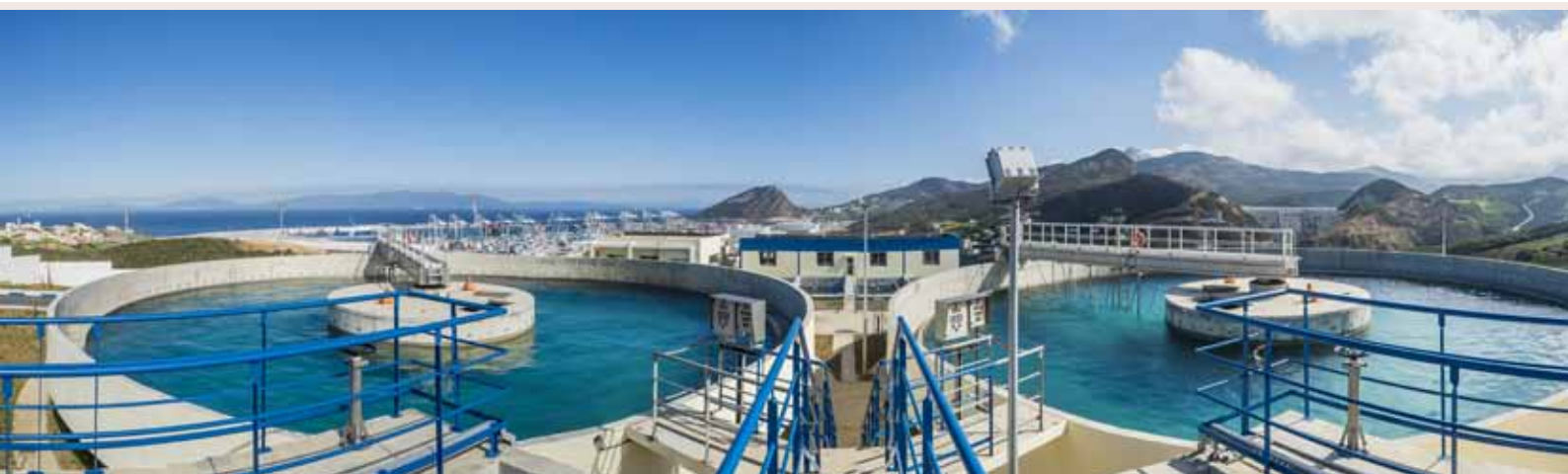
Station de traitement – Tanger Med
